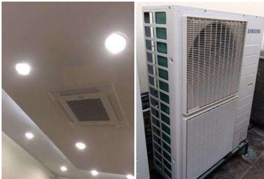
Unidad de aire acondicionado a reparar.
