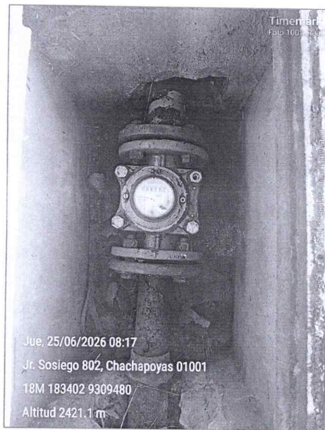
Macromedidor de 50 mm (2")
