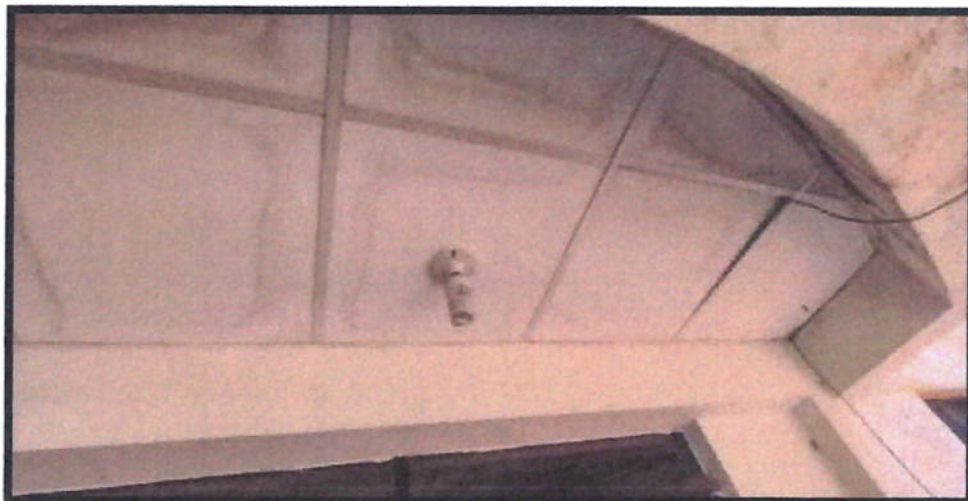
IMAGEN N°05: EN LA FOTOGRAFÍA SE OBSERVA EL DETERIORO DEL CIELO RASO A CAUSA DE LAS LLUVIAS
