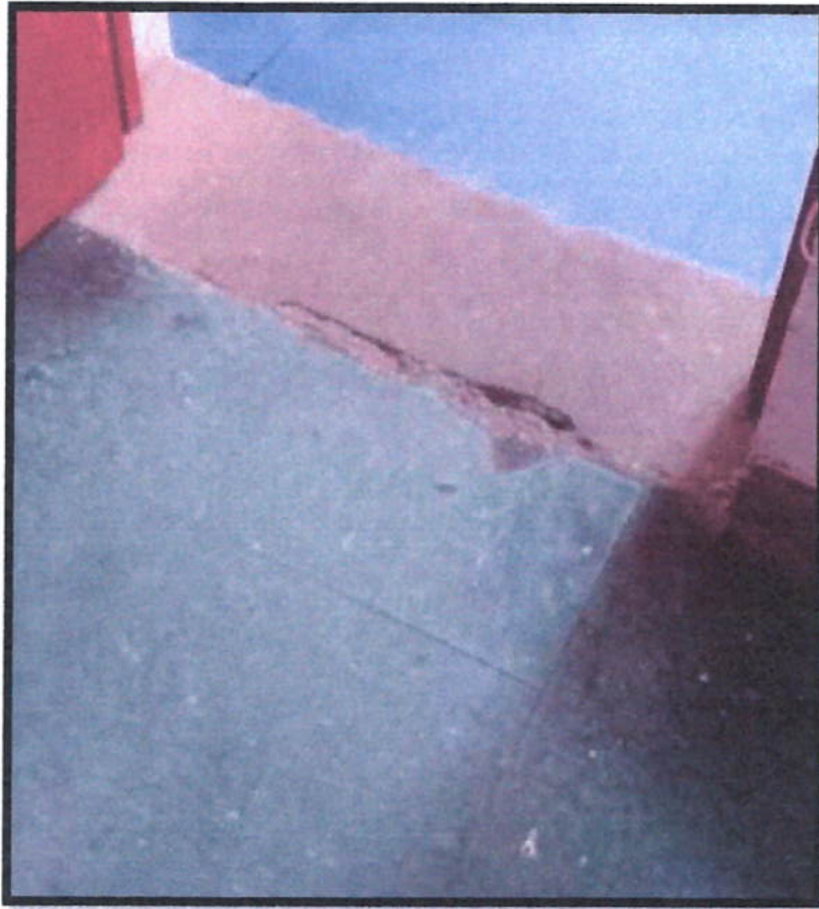
IMAGEN N°04: EN LA FOTOGRAFÍA SE OBSERVA LA CONTINUACIÓN DEL PISO DE MAYÓLICA EN EL BORDE DE LA PUERTA
