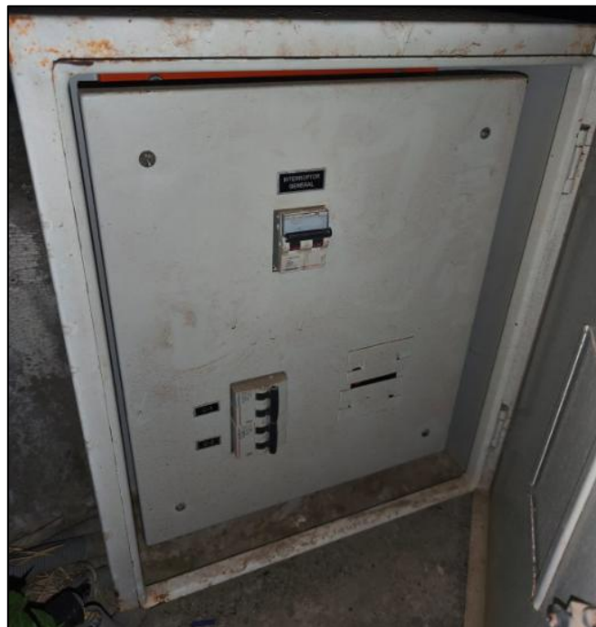
Vista de la electrobomba y tablero de control
