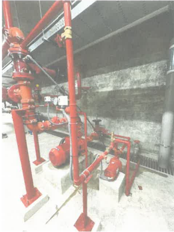
Imagen 03: Imagen se sistema de agua contraincendios.
