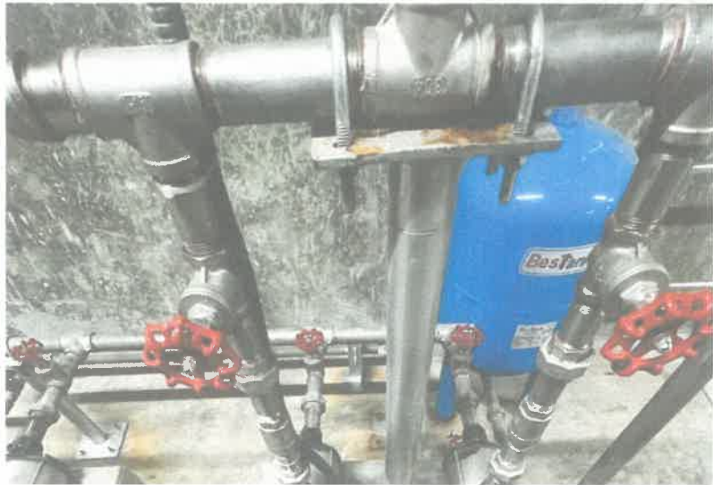
Imagen 01: Imagen de sistema de impulsión de agua de ablandador
