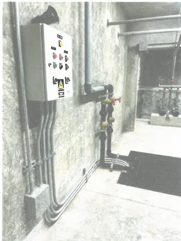
Imagen 02: Imagen se sistema de impulsión de agua del pozo sumidero.
