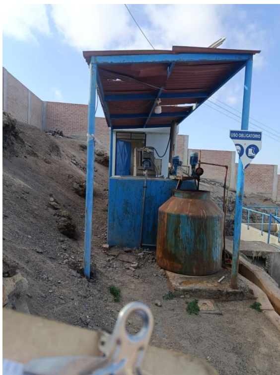
Foto 03. Estructura y techo de punto de preparación de cloruro férrico en PTAP La Curva en estado deficiente, debe ser tener mantenimiento y renovación
