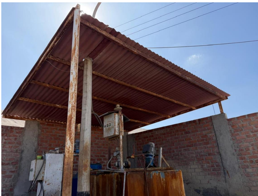
Foto 04. Estructura corroída, techo de Eternit en malas condiciones, en punto de preparación de cloruro férrico en PTAP El Arenal, debe tener techo y renovación
