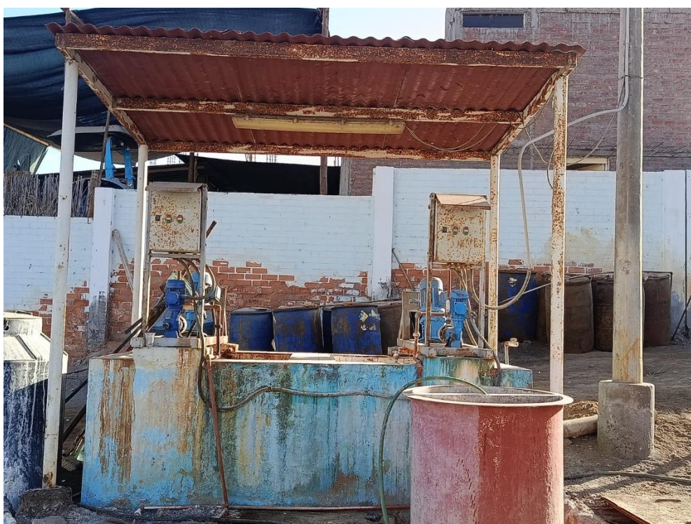
Foto 05. Estructura corroída, techo de Eternit en malas condiciones, en punto de preparación de cloruro férrico en PTAP 01 Cocachacra, debe tener techo y renovación
