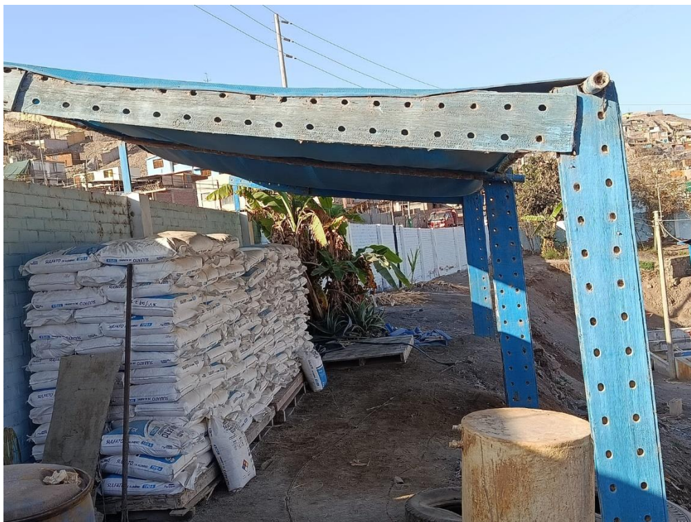
Foto 06. Estructura de madera y techo de malla rashell en malas condiciones, en punto de ubicación de sulfato de aluminio tipo A en PTAP Cocachacra, debe ser renovado
