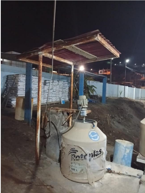
Foto 08. Estructura corroída, techo de Eternit en malas condiciones, en punto de preparación de hipoclorito de calcio en PTAP 02 Cocachacra, debe tener mantenimiento y renovación
