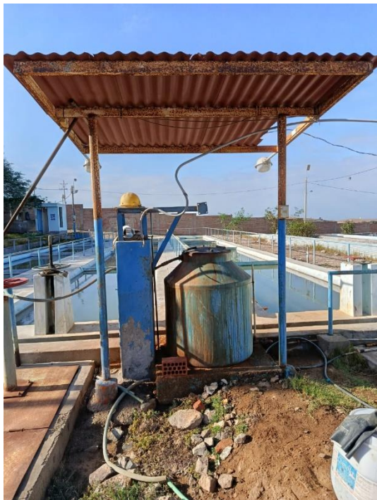
Foto 01. Estructura y Techo de punto de preparación de cloruro férrico en PTAP Mejía, se encuentra en malas condiciones
