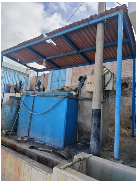
Foto 04. Estructura corroída, techo de Eternit en malas condiciones, en PTAP La Curva, debe tener mantenimiento y renovación
