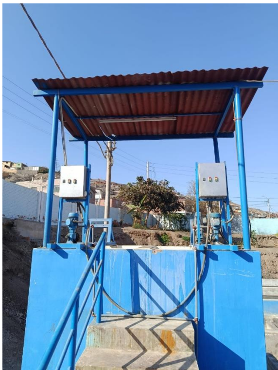
Foto 07. Estructura corroída, techo de Eternit en malas condiciones, en punto de preparación de cloruro férrico en PTAP 02 Cocachacra, debe ser tener mantenimiento y renovación
