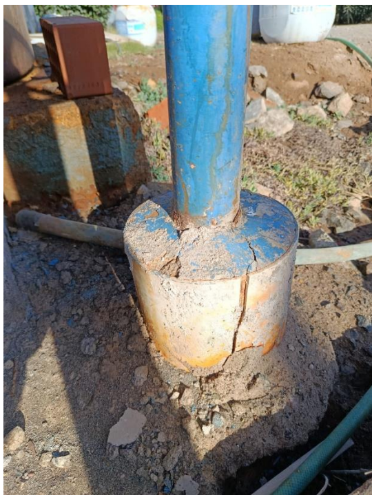
Foto 02. Base de parantes de estructura en PTAP Mejía en estado deficiente, debe tener mantenimiento y renovación
