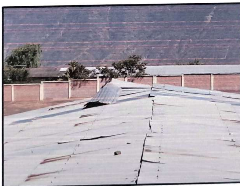
Foto 6: La imagen muestra calaminas sueltas por el deterioro de estas y de los elementos de anclaje.
