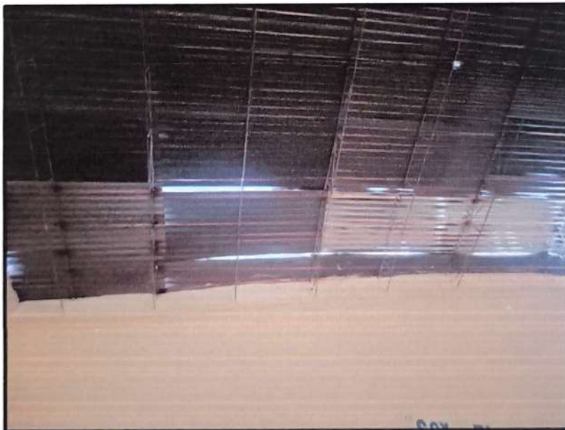
Foto 4: La imagen muestra deterioro de la calamina.
