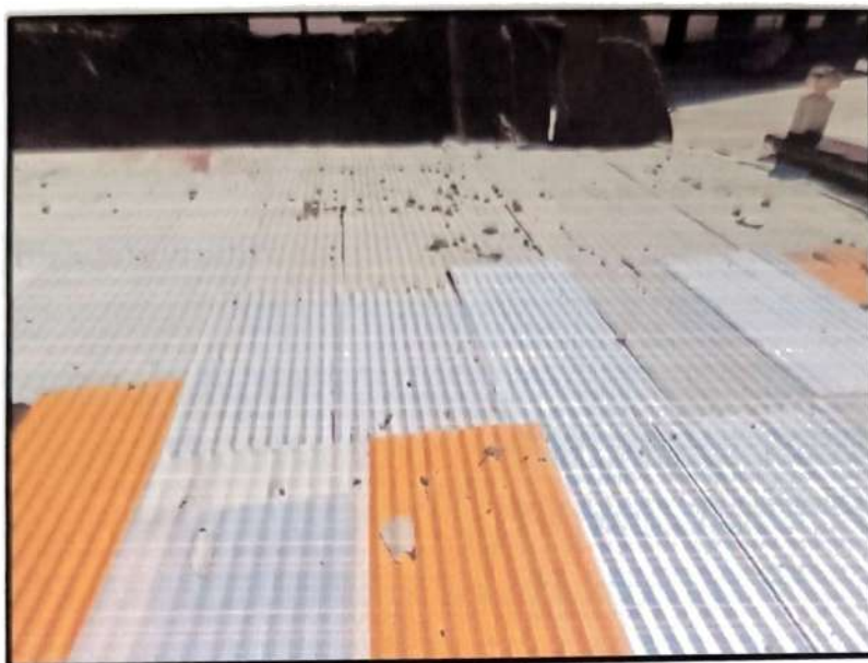
Foto 5: La imagen muestra deterioro de la calamina.
