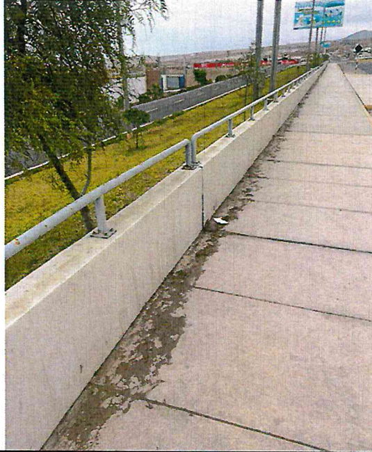
INFRAESTRUCTURA VIAL EXISTENTE SECTOR APIAMO – PINTADO DE BARANDAS DE CONCRETO Y BARANDAS METÁLICAS
