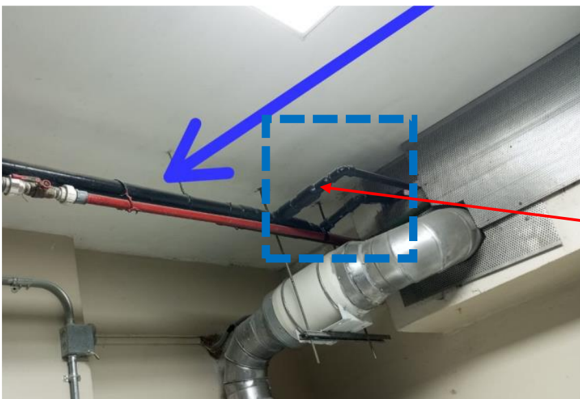
Imagen 10: Ingresa a sótano (Tienda 116) desde el exterior tubería de 2" que abastece a la cisterna.
