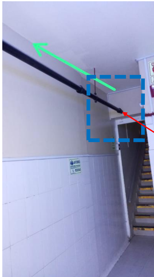
Imagen 9: Tubería de ventilación de 2" sale suspendida al sótano (Tienda 116) desde el pozo séptico y empalma con tubería de 2", hasta azotea.
