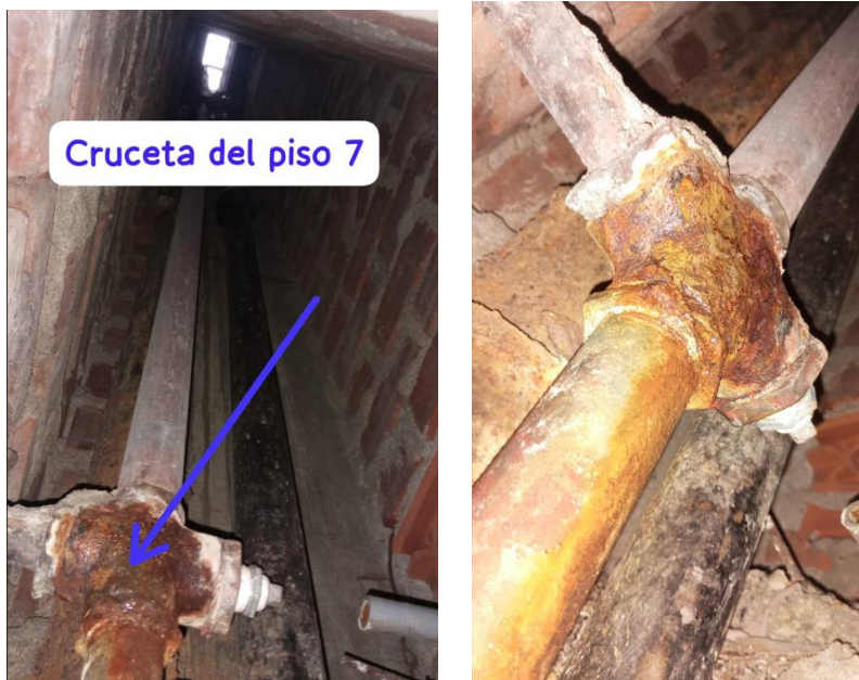
Imagen 4: Empalme de tubería montante de agua de F°G° de Ø 2" con tubería de distribución de baño y cocina en cada piso ( uno en cada lado).
