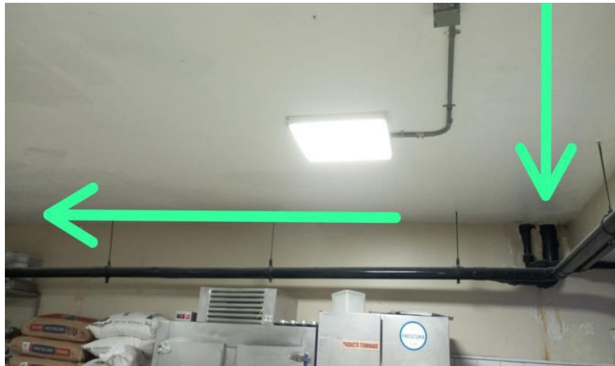
Imagen 8: Tubería de desagüe de F°G° de 4" llega suspendida al sótano (Henda 116) y empalma con tubería existente de PVC SAP de 4" ,que va hasta a la red colectora exterior del inmueble
