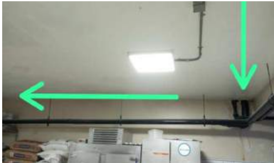
Imagen 8: Tubería de desagüe de F°G° de 4" llega suspendida al sótano (Henda 116) y empalma con tubería existente de PVC SAP de 4" ,que va hasta a la red colectora exterior del inmueble
