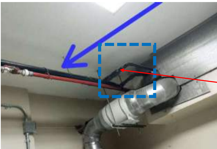
Imagen 10: Ingresa a sótano (Tienda 116) desde el exterior tubería de 2" que abastece a la cisterna.
