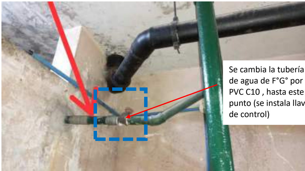
Imagen 11: Tubería de F°G° 2" viene desde el exterior hacia el sótano (pasa por la tienda 116 y áreas comunes del sótano) y alimenta a la cisterna.
