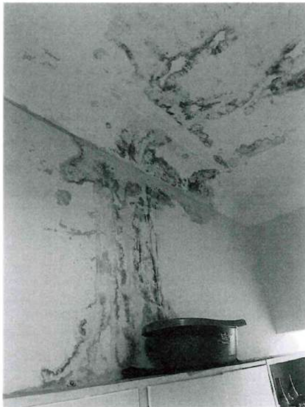
Filtración en el piso inferior
