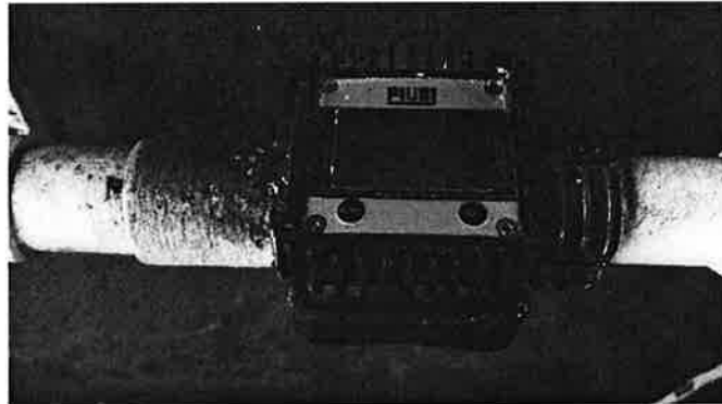
Medidor N° 4: Atico - Medidor entrada grupo electrógeno, para LONGEN (de 1")
