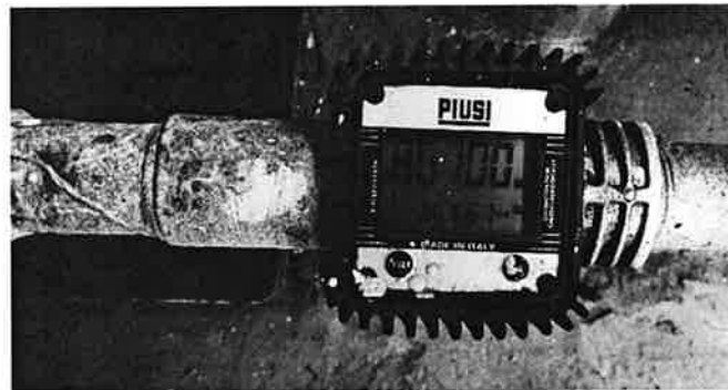
Medidor N° 5: Atico - Medidor entrada grupo electrógeno, para Perkins 3 (de 1")
