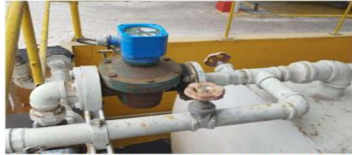
Medidor N° 1: Atico - Medidor entrada tanque principal (tipo brida 2")
