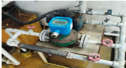
Medidor N° 2: Atico - Medidor salida tanque principal (tipo brida 1")
