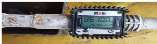
Medidor N° 5: Atico - Medidor entrada grupo electrógeno, para Perkins 3 (de 1")
