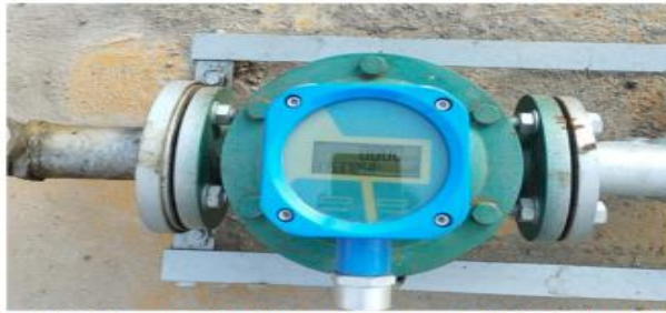
Medidor N° 2: Chococo - Medidor salida tanque principal (tipo brida 1")
