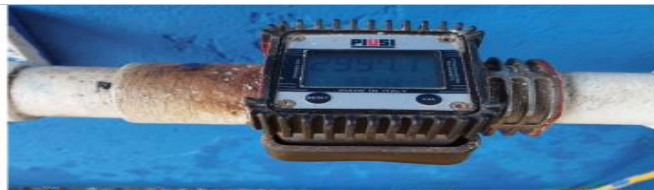
Medidor N° 4: Atico - Medidor entrada grupo electrógeno, para LONGEN (de 1")
