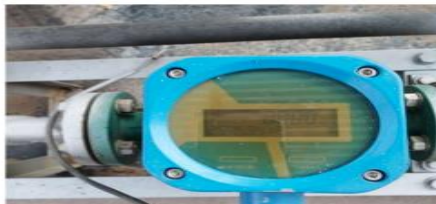
Medidor N° 1: Chococo - Medidor entrada tanque principal (tipo brida 2")
