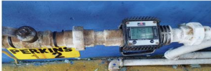
Medidor N° 3: Atico - Medidor entrada grupo electrógeno, para Perkins 1 y Perkins 2 (de 1")
