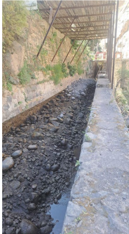
Imagen 1. Material sedimentado en canal de captación.
