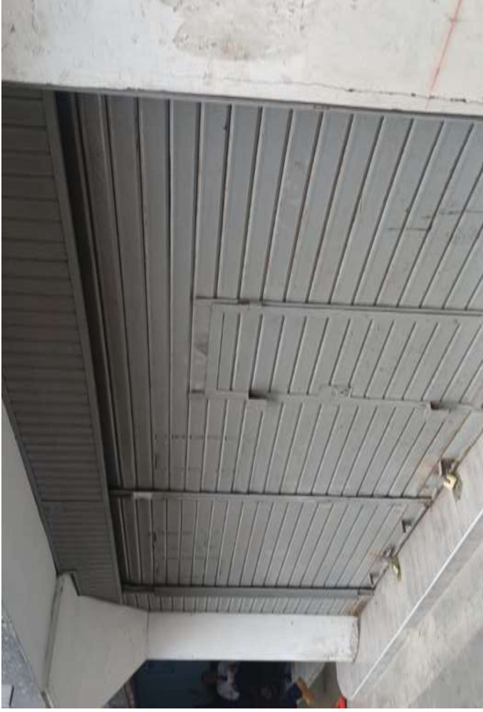
Pintura de las puertas enrollables con rayones y suciedad
