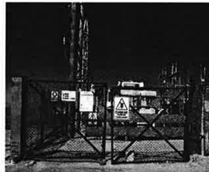
Estado del cerco y puerta de acceso
