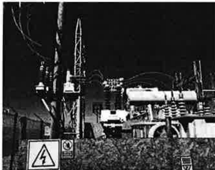
Equipos en la SET Alto Cayma
