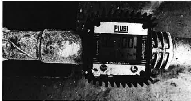
Medidor N° 5: Atico - Medidor entrada grupo electrógeno, para Perkins 3 (de 1")
