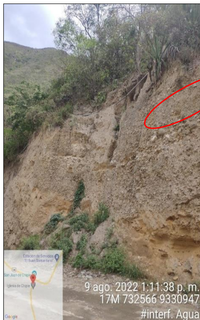
Imagen N° 6. Línea de conducción adosada a talud Km 91+500 de la Vía Cochabamba – Cutervo-Chiple
