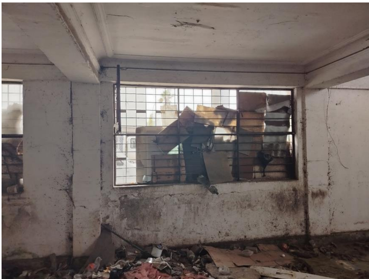
Imagen N° 10.- Desmonte, escombros y elementos en desuso ubicados en el inmueble denominado Ex Banco Popular Pizarro
