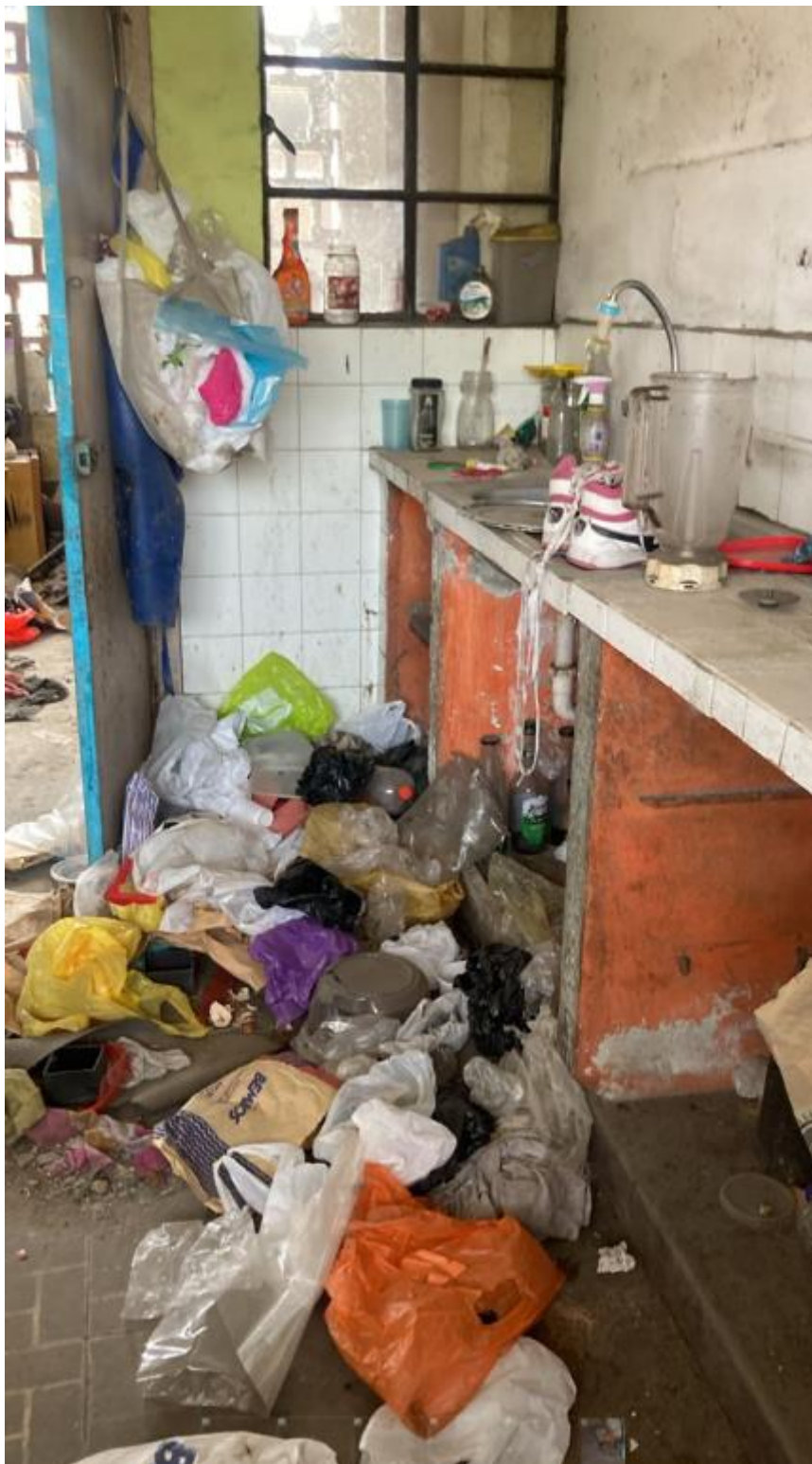
Imagen N° 6.- Desmote, escombros y elementos en desuso ubicados en el inmueble denominado 28 de Julio, bloque A
