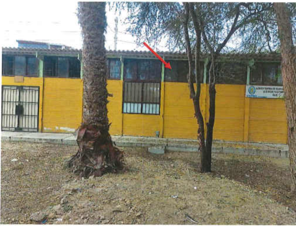
Fotografía 5. T1 BARRACA Elevación posterior. Laminado de vidrio y reemplazo de vidrio roto.
