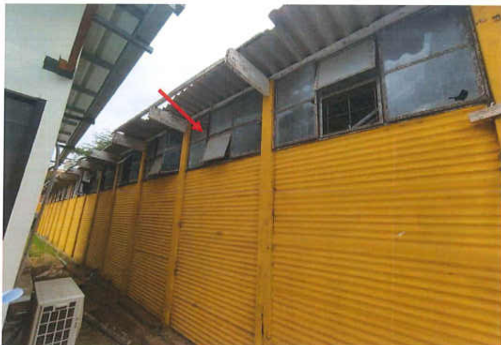
Fotografía 3. T6 BARRACA Elevación posterior. Laminado de vidrio y reemplazo de vidrio roto.
