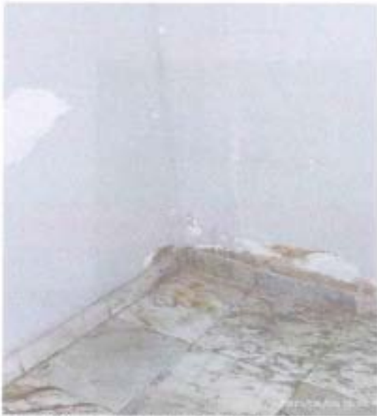
Foto 06 resquebrajamiento de pintura
