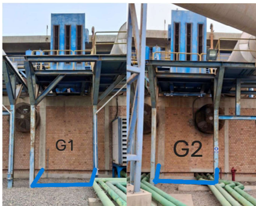
Figura 06: Adecuación de losa para filtros de aire de carga de G1 y G2
