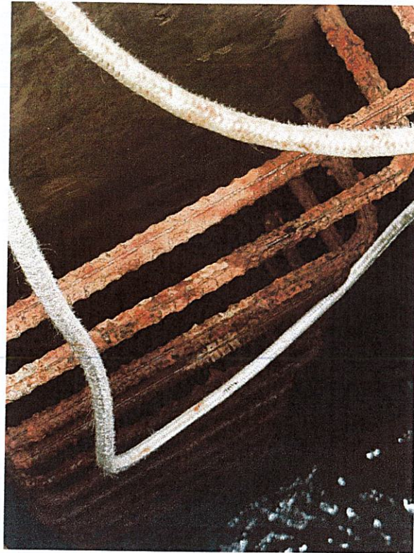
IMAGEN N°01: ESCALERA TIPO RUSTICO OXIDADA (diseñado con varillas corrugadas de construcción)
