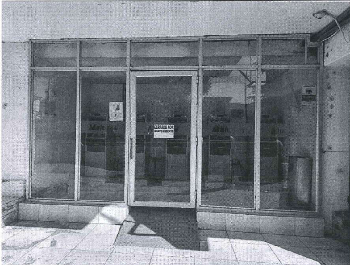
Imagen 3 Mampara de vidrio existente, se deberá reemplaza el vidrio por plancha de galvanizada de 1/16 mm.
