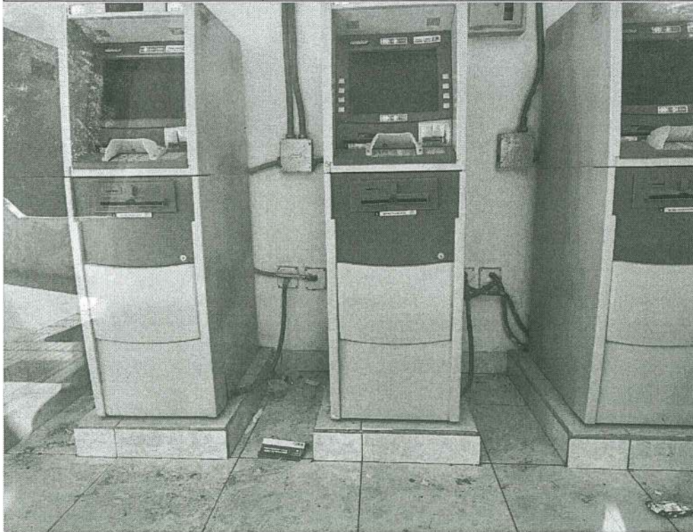
Imagen 1. Cajeros Pedestal existentes en el Lobby 1er Piso FEBAN
